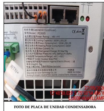
FOTO DE PLACA DE UNIDAD CONDENSADORA
