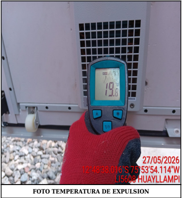
FOTO TEMPERATURA DE EXPULSION
