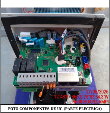
FOTO COMPONENTES DE UC (PARTE ELECTRICA)
