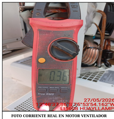
FOTO CORRIENTE REAL EN MOTOR VENTILADOR
