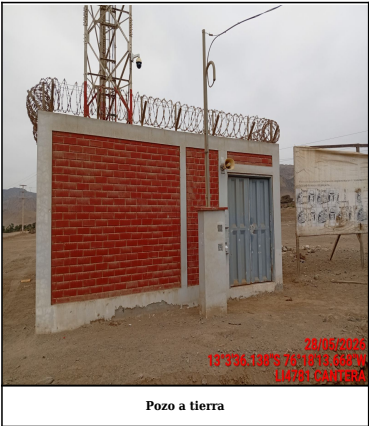
Pozo a tierra
