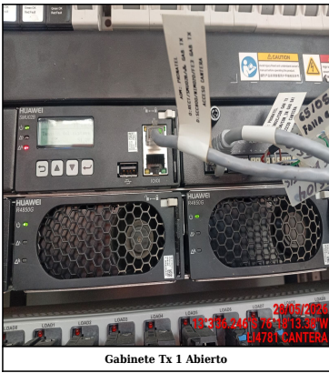
Gabinete Tx 1 Abierto
