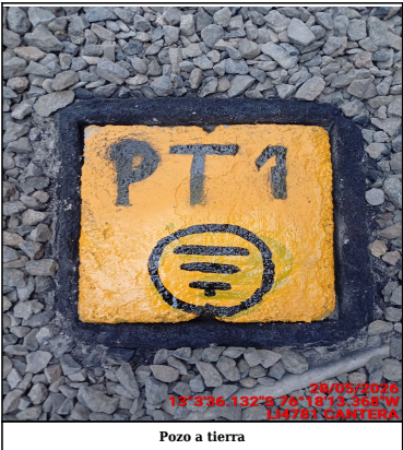
Pozo a tierra
