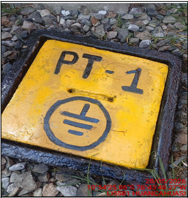
Pozo a tierra
