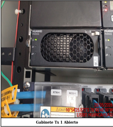
Gabinete Tx 1 Abierto
