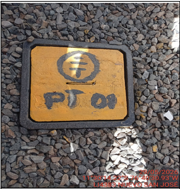
Pozo a tierra
