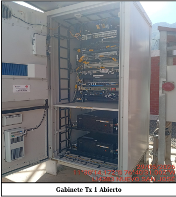
Gabinete Tx 1 Abierto
