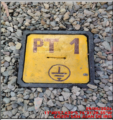
Pozo a tierra
