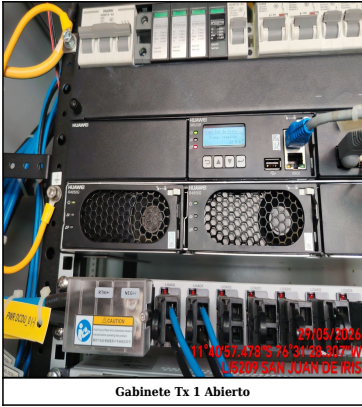
Gabinete Tx 1 Abierto
