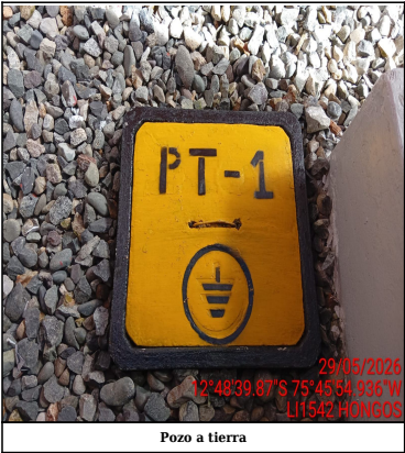
Pozo a tierra
