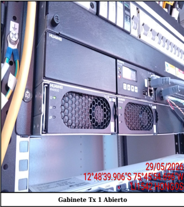
Gabinete Tx 1 Abierto
