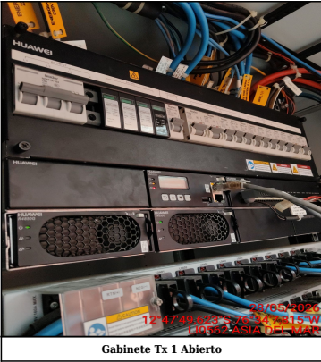
Gabinete Tx 1 Abierto
