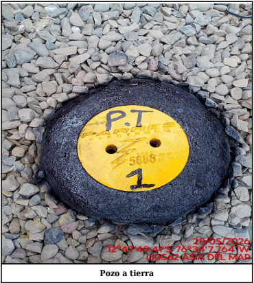
Pozo a tierra
