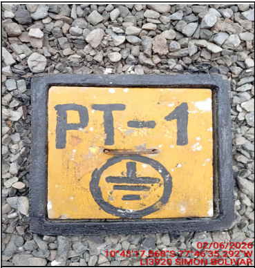
Pozo a tierra
