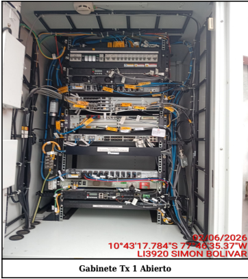
Gabinete Tx 1 Abierto
