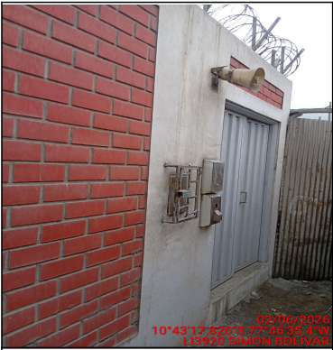
Pozo a tierra
