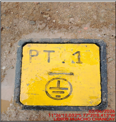
Pozo a tierra
