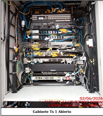
Gabinete Tx 1 Abierto
