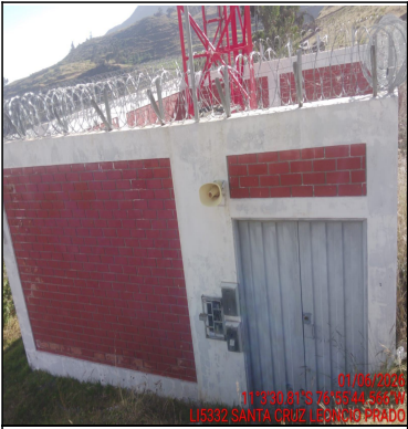
Pozo a tierra
