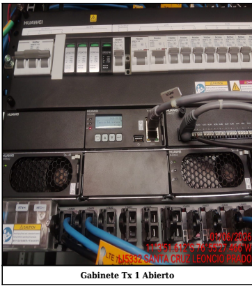
Gabinete Tx 1 Abierto
