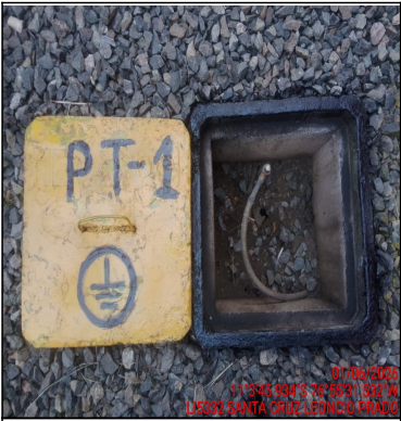
Pozo a tierra
