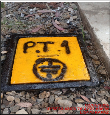
Pozo a tierra
