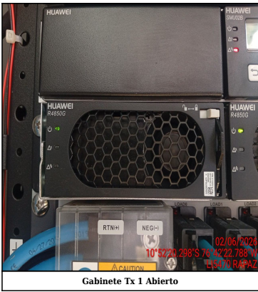
Gabinete Tx 1 Abierto
