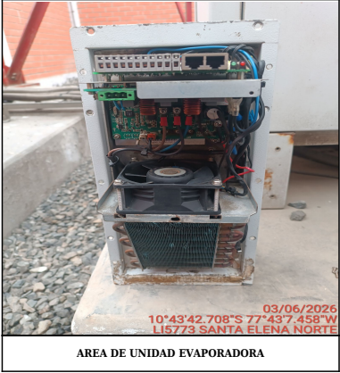
AREA DE UNIDAD EVAPORADORA
