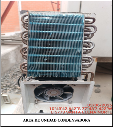
AREA DE UNIDAD CONDENSADORA
