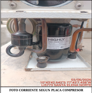
FOTO CORRIENTE SEGUN PLACA COMPRESOR
