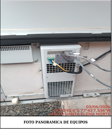
FOTO PANORAMICA DE EQUIPOS
