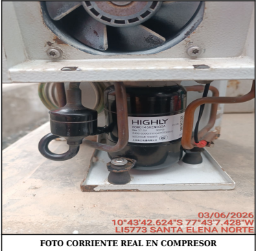
FOTO CORRIENTE REAL EN COMPRESOR
