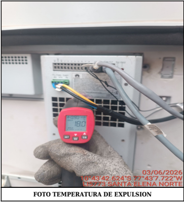
FOTO TEMPERATURA DE EXPULSION
