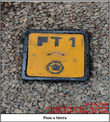
Pozo a tierra
