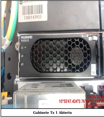
Gabinete Tx 1 Abierto
