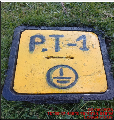
Pozo a tierra
