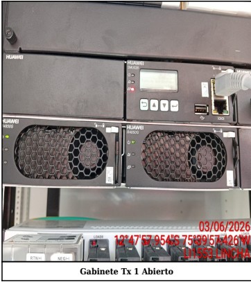
Gabinete Tx 1 Abierto
