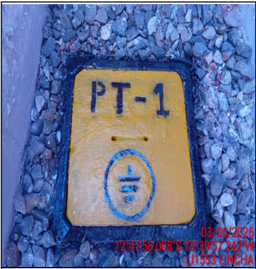
Pozo a tierra
