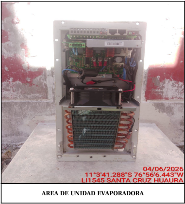
AREA DE UNIDAD EVAPORADORA
