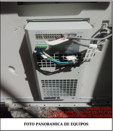
FOTO PANORAMICA DE EQUIPOS
