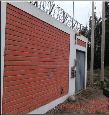
Pozo a tierra
