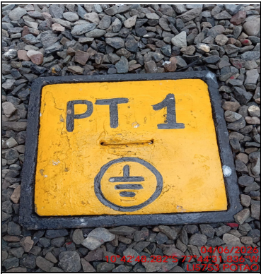
Pozo a tierra
