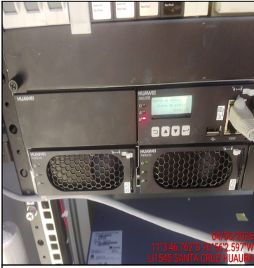
Gabinete Tx 1 Abierto
