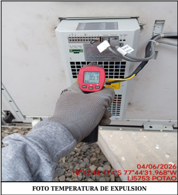
FOTO TEMPERATURA DE EXPULSION
