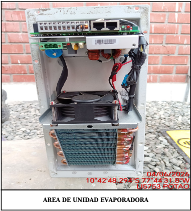
AREA DE UNIDAD EVAPORADORA
