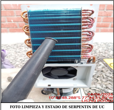
FOTO LIMPIEZA Y ESTADO DE SERPENTIN DE UC
