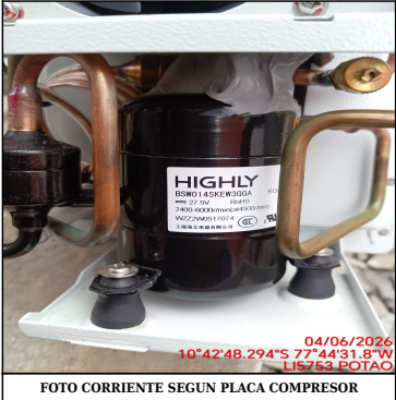
FOTO CORRIENTE SEGUN PLACA COMPRESOR
