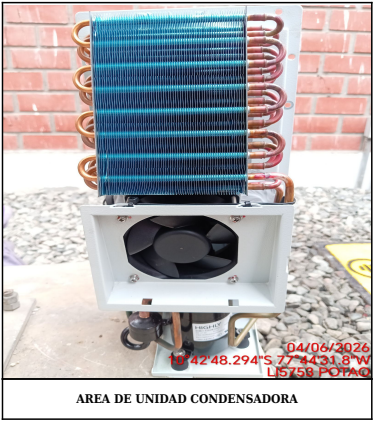
AREA DE UNIDAD CONDENSADORA
