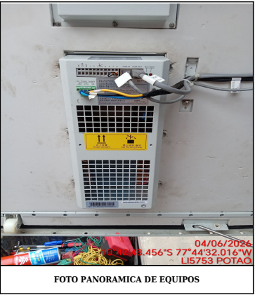
FOTO PANORAMICA DE EQUIPOS
