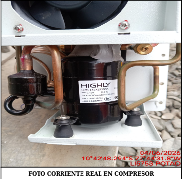
FOTO CORRIENTE REAL EN COMPRESOR
