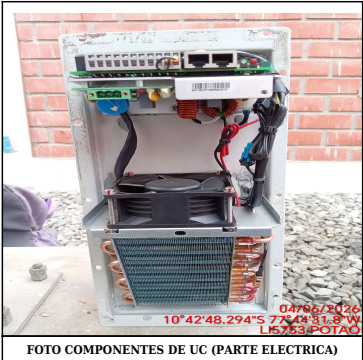
FOTO COMPONENTES DE UC (PARTE ELECTRICA)
