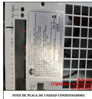
FOTO DE PLACA DE UNIDAD CONDENSADORA
