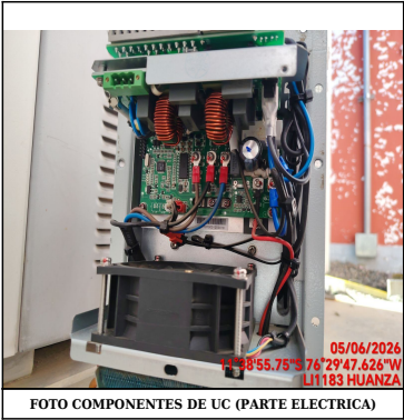
FOTO COMPONENTES DE UC (PARTE ELECTRICA)
