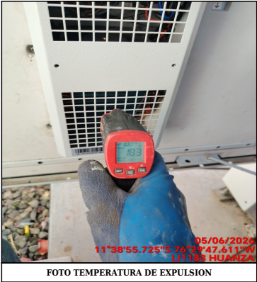
FOTO TEMPERATURA DE EXPULSION
