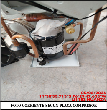
FOTO CORRIENTE SEGUN PLACA COMPRESOR
