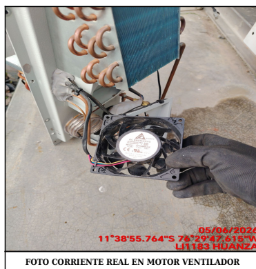
FOTO CORRIENTE REAL EN MOTOR VENTILADOR
