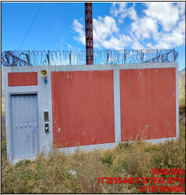
Pozo a tierra
