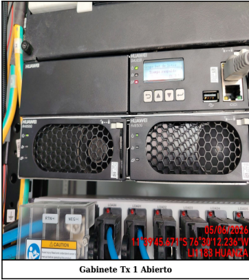
Gabinete Tx 1 Abierto
