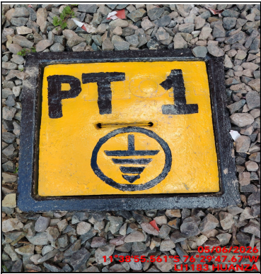
Pozo a tierra
