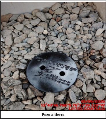
Pozo a tierra
