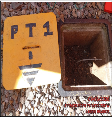
Pozo a tierra
