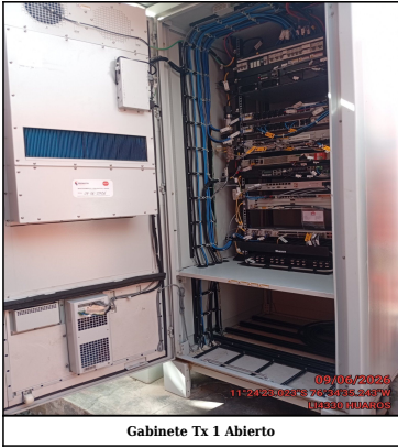
Gabinete Tx 1 Abierto
