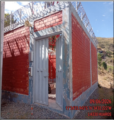
Pozo a tierra
