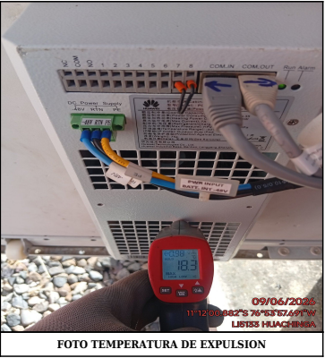
FOTO TEMPERATURA DE EXPULSION
