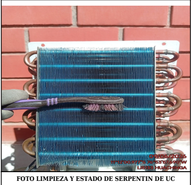
FOTO LIMPIEZA Y ESTADO DE SERPENTIN DE UC
