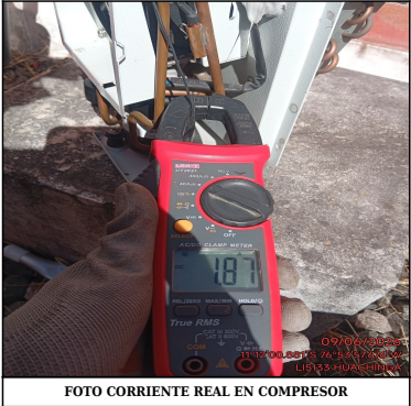
FOTO CORRIENTE REAL EN COMPRESOR
