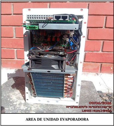
AREA DE UNIDAD EVAPORADORA
