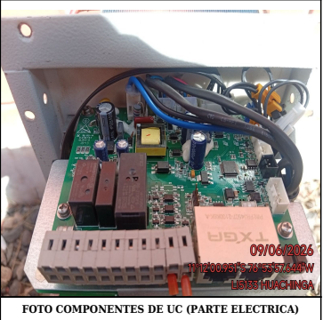
FOTO COMPONENTES DE UC (PARTE ELECTRICA)
