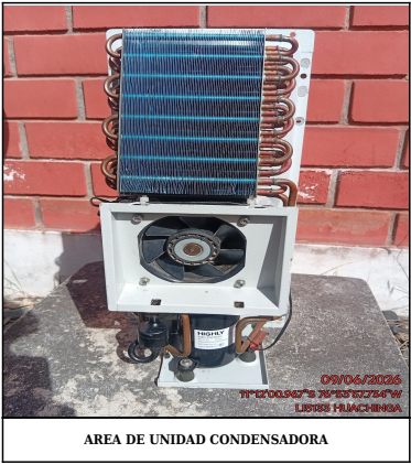
AREA DE UNIDAD CONDENSADORA
