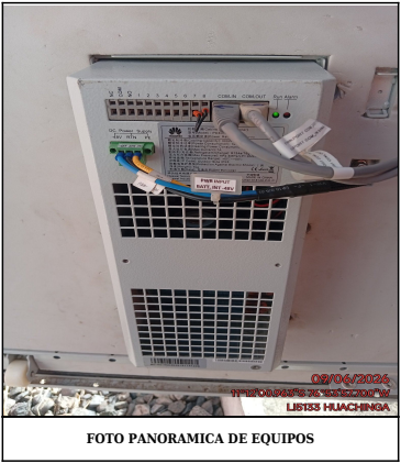
FOTO PANORAMICA DE EQUIPOS
