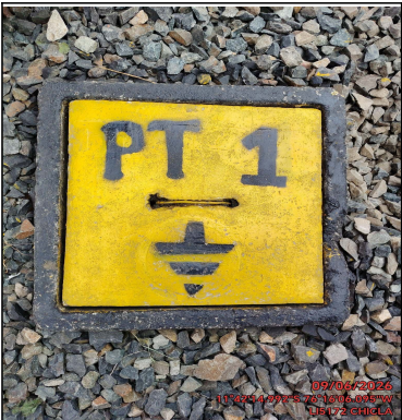
Pozo a tierra
