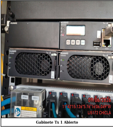
Gabinete Tx 1 Abierto
