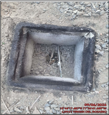
Pozo a tierra
