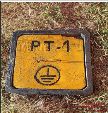
Pozo a tierra
