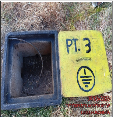
Pozo a tierra
