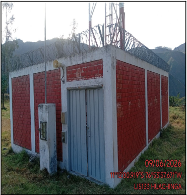
Pozo a tierra
