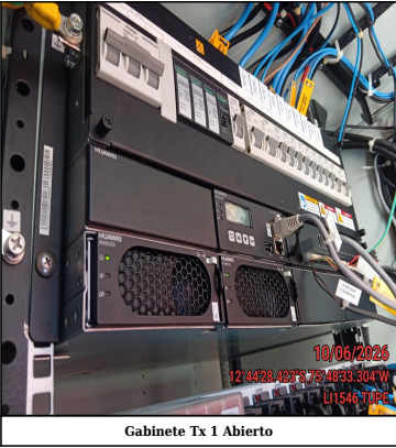
Gabinete Tx 1 Abierto
