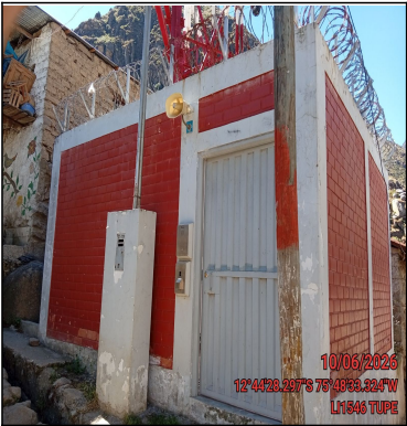
Pozo a tierra
