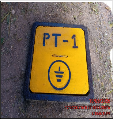
Pozo a tierra
