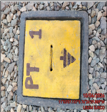
Pozo a tierra
