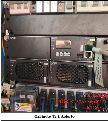
Gabinete Tx 1 Abierto
