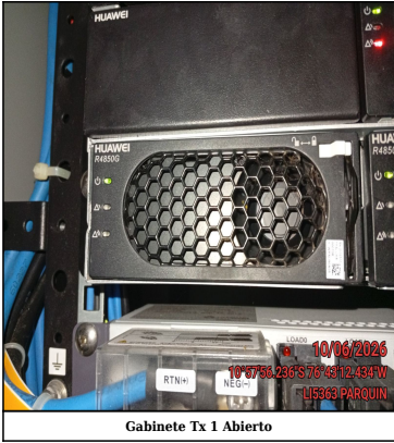
Gabinete Tx 1 Abierto
