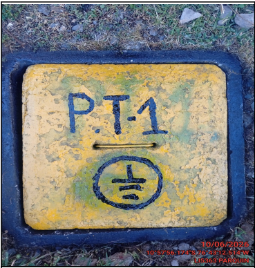
Pozo a tierra
