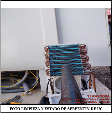
FOTO LIMPIEZA Y ESTADO DE SERPENTIN DE UC
