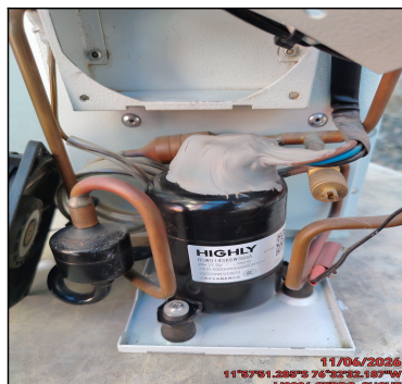
FOTO DE COMPRESOR
