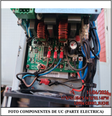
FOTO COMPONENTES DE UC (PARTE ELECTRICA)
