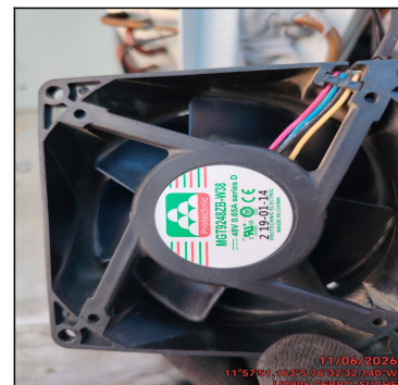
FOTO CORRIENTE SEGUN PLACA EN MOTOR VENTILADOR
