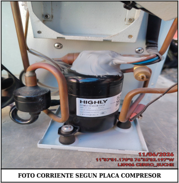
FOTO CORRIENTE SEGUN PLACA COMPRESOR
