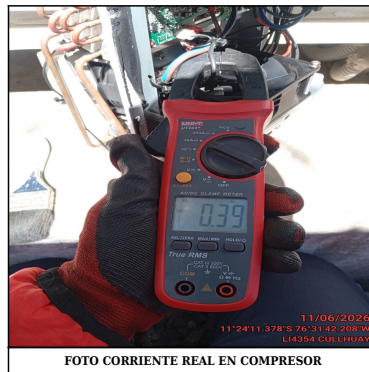
FOTO CORRIENTE REAL EN COMPRESOR
