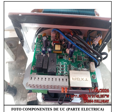
FOTO COMPONENTES DE UC (PARTE ELECTRICA)
