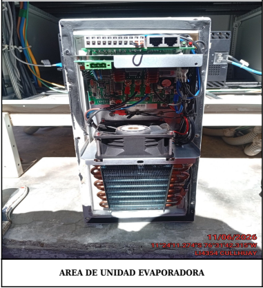
AREA DE UNIDAD EVAPORADORA
