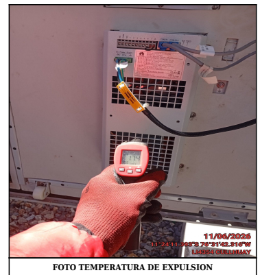
FOTO TEMPERATURA DE EXPULSION
