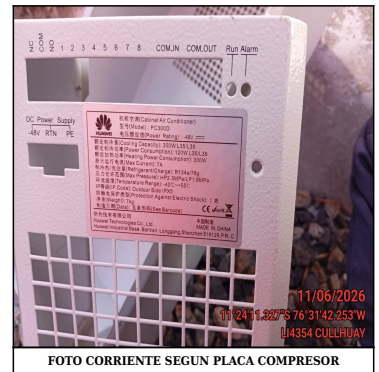
FOTO CORRIENTE SEGUN PLACA COMPRESOR
