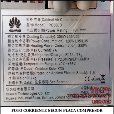
FOTO CORRIENTE SEGUN PLACA COMPRESOR
