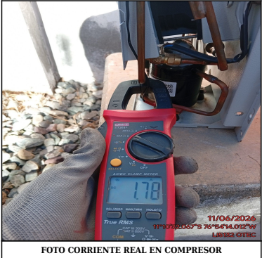
FOTO CORRIENTE REAL EN COMPRESOR
