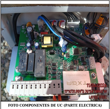
FOTO COMPONENTES DE UC (PARTE ELECTRICA)
