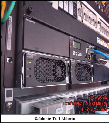
Gabinete Tx 1 Abierto
