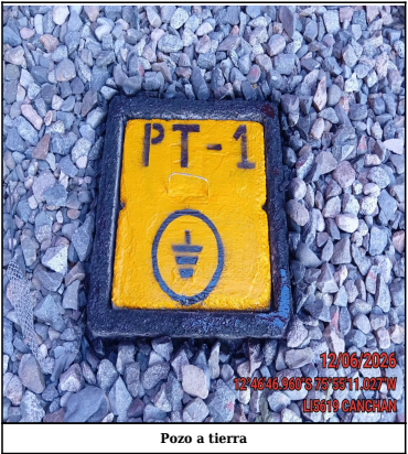
Pozo a tierra
