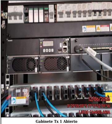
Gabinete Tx 1 Abierto
