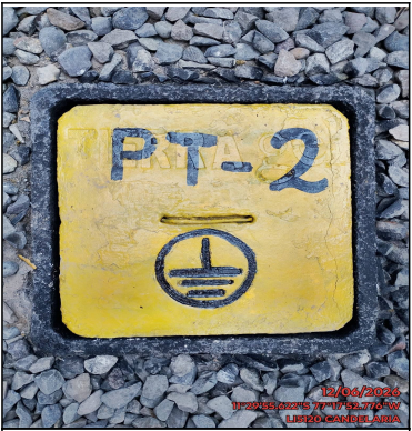
Pozo a tierra
