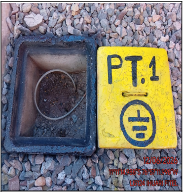
Pozo a tierra
