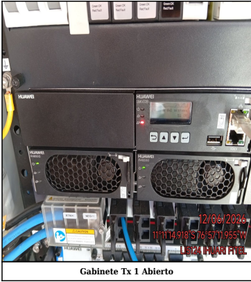
Gabinete Tx1 Abierto
