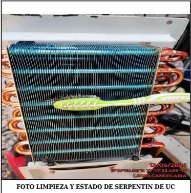
FOTO LIMPIEZA Y ESTADO DE SERPENTIN DE UC
