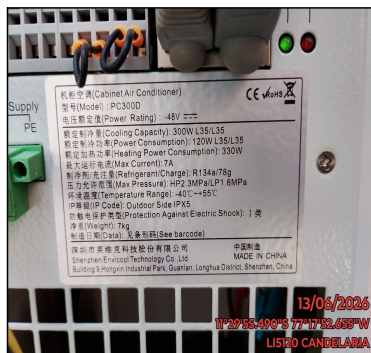
FOTO DE PLACA DE UNIDAD EVAPORADORA
