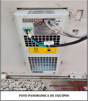
FOTO PANORAMICA DE EQUIPOS
