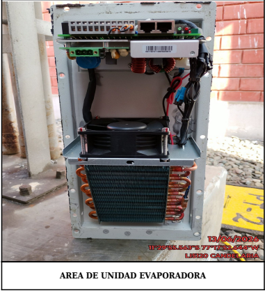
AREA DE UNIDAD EVAPORADORA
