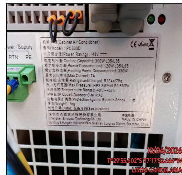
FOTO DE PLACA DE UNIDAD CONDENSADORA
