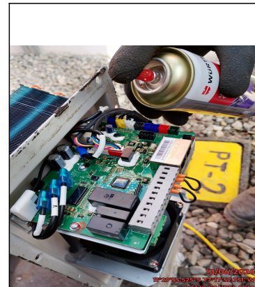
FOTO DE COMPONENTES DE UE (PARTE ELECTRICA)
