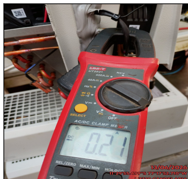
FOTO CORRIENTE REAL EN MOTOR VENTILADOR
