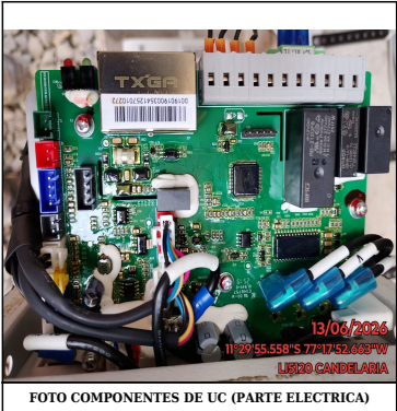
FOTO COMPONENTES DE UC (PARTE ELECTRICA)
