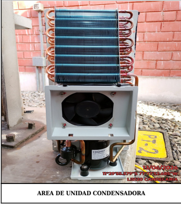
AREA DE UNIDAD CONDENSADORA
