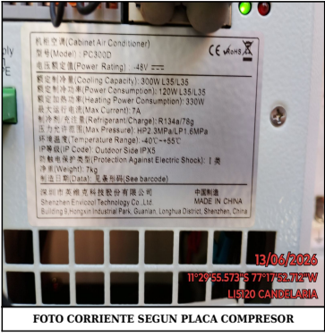
FOTO CORRIENTE SEGUN PLACA COMPRESOR
