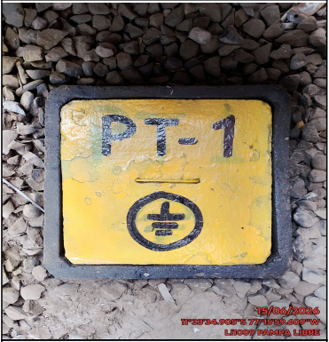
Pozo a tierra
