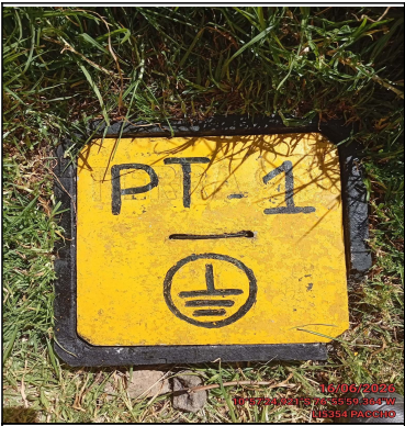
Pozo a tierra
