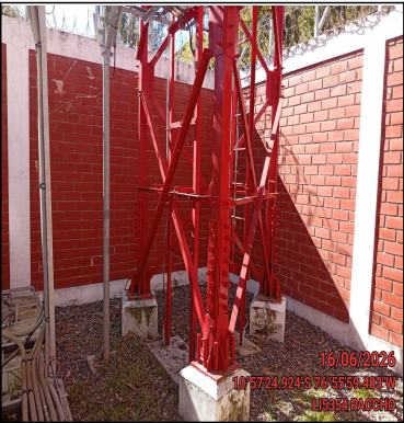
Foto Panorámica del Interior del Site
