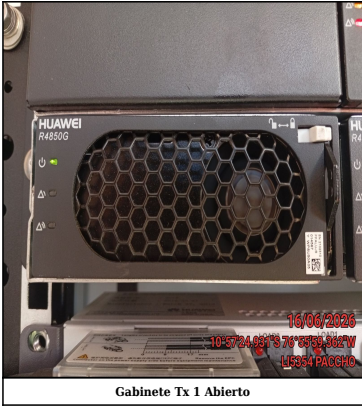
Gabinete Tx 1 Abierto
