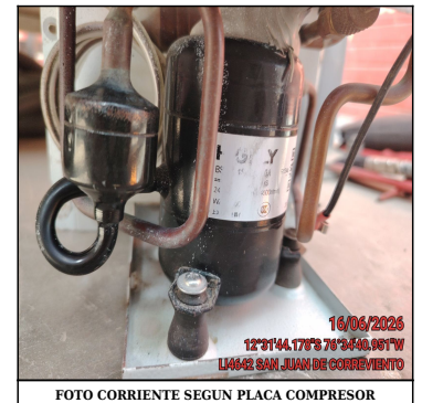
FOTO CORRIENTE SEGUN PLACA COMPRESOR
