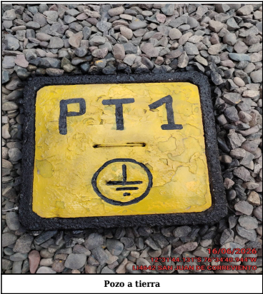
Pozo a tierra
