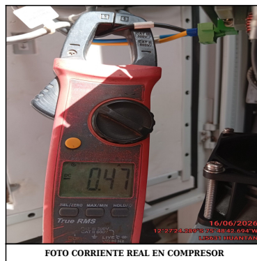
FOTO CORRIENTE REAL EN COMPRESOR
