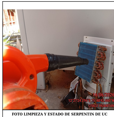
FOTO LIMPIEZA Y ESTADO DE SERPENTIN DE UC
