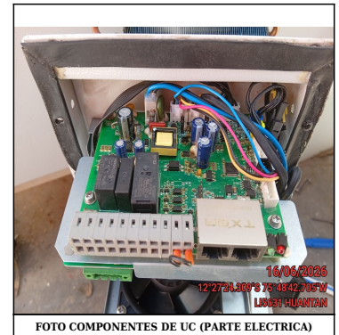
FOTO COMPONENTES DE UC (PARTE ELECTRICA)
