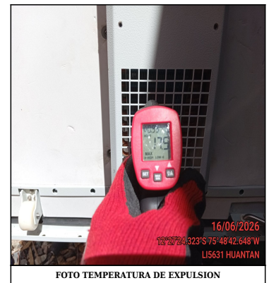
FOTO TEMPERATURA DE EXPULSION
