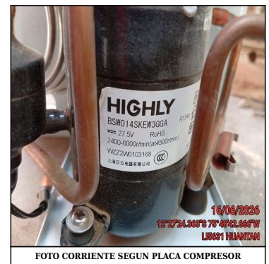
FOTO CORRIENTE SEGUN PLACA COMPRESOR
