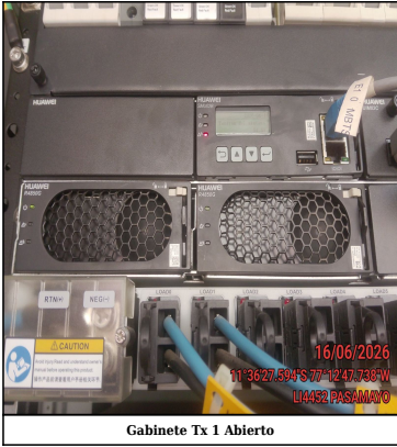
Gabinete Tx 1 Abierto
