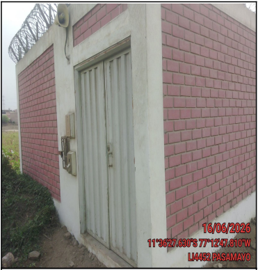
Pozo a tierra
