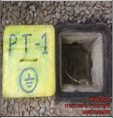
Pozo a tierra
