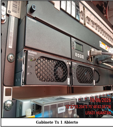
Gabinete Tx 1 Abierto
