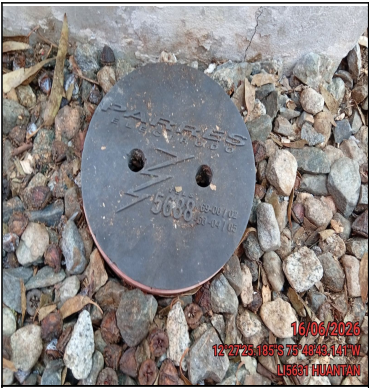
Pozo a tierra
