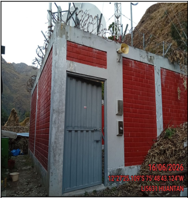
Pozo a tierra
