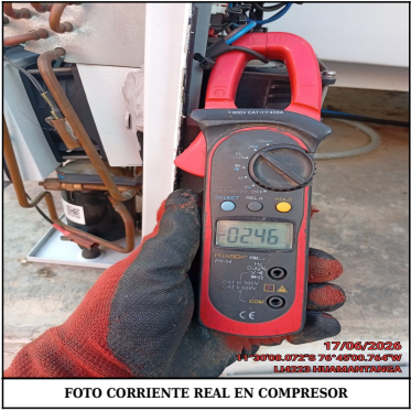
FOTO CORRIENTE REAL EN COMPRESOR
