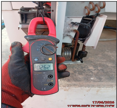
FOTO CORRIENTE REAL EN MOTOR VENTILADOR
