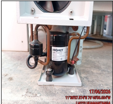
FOTO DE COMPRESOR
