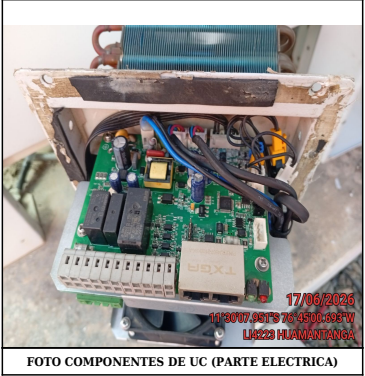
FOTO COMPONENTES DE UC (PARTE ELECTRICA)
