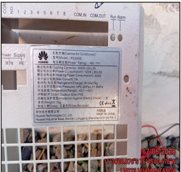
FOTO CORRIENTE SEGUN PLACA EN MOTOR VENTILADOR
