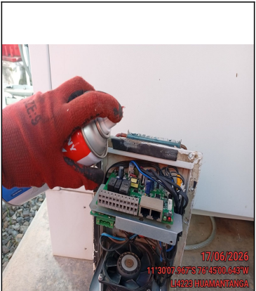
FOTO DE COMPONENTES DE UE (PARTE ELECTRICA)
