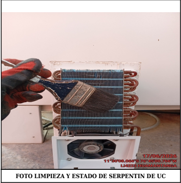
FOTO LIMPIEZA Y ESTADO DE SERPENTIN DE UC
