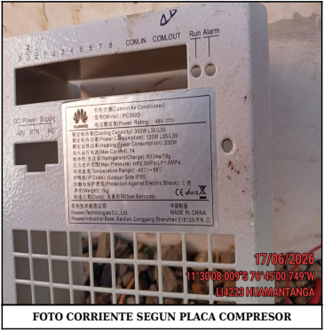
FOTO CORRIENTE SEGUN PLACA COMPRESOR
