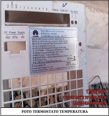
FOTO TERMOSTATO TEMPERATURA
