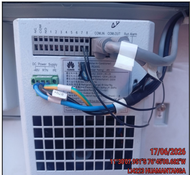
FOTO DE PLACA DE UNIDAD EVAPORADORA
