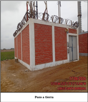
Pozo a tierra
