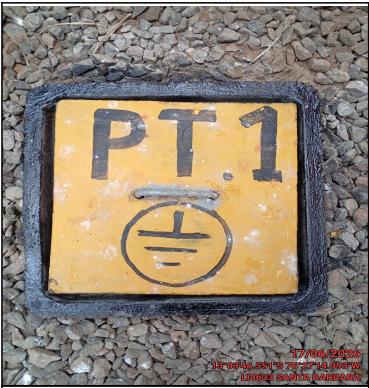
Pozo a tierra
