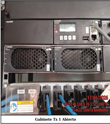
Gabinete Tx 1 Abierto
