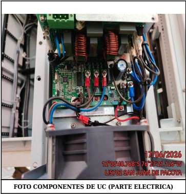
FOTO COMPONENTES DE UC (PARTE ELECTRICA)
