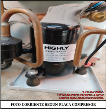
FOTO CORRIENTE SEGUN PLACA COMPRESOR
