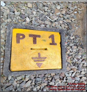
Pozo a tierra
