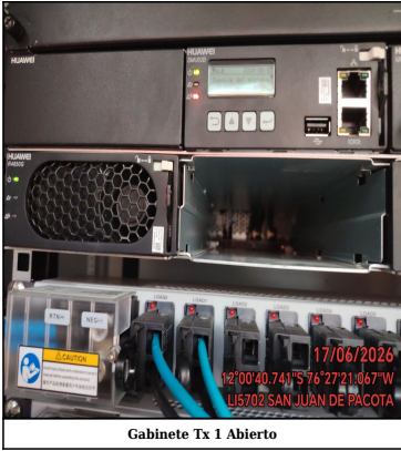
Gabinete Tx 1 Abierto
