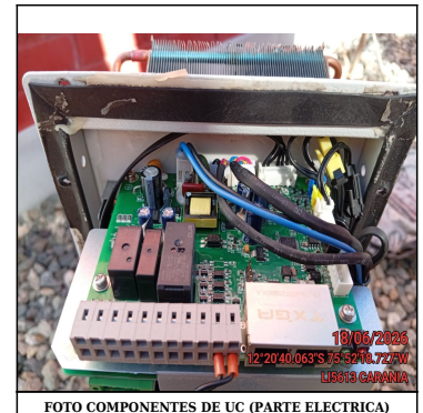
FOTO COMPONENTES DE UC (PARTE ELECTRICA)
