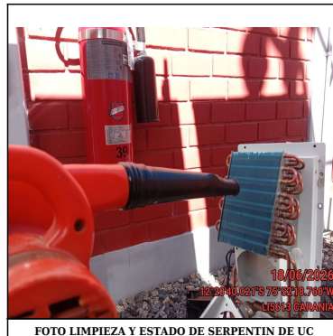
FOTO LIMPIEZA Y ESTADO DE SERPENTIN DE UC
