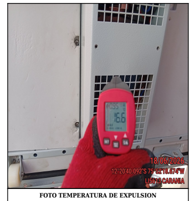
FOTO TEMPERATURA DE EXPULSION
