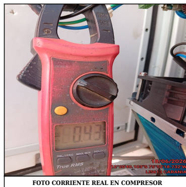
FOTO CORRIENTE REAL EN COMPRESOR
